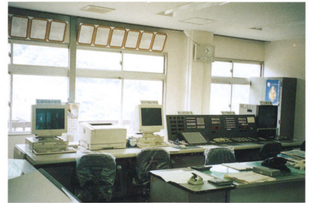
ダム管理事務所遠方操作設備
