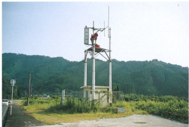
警報局施設(石打警報局)
