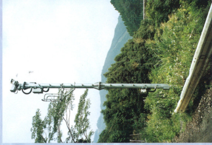
ダム監視カメラ
